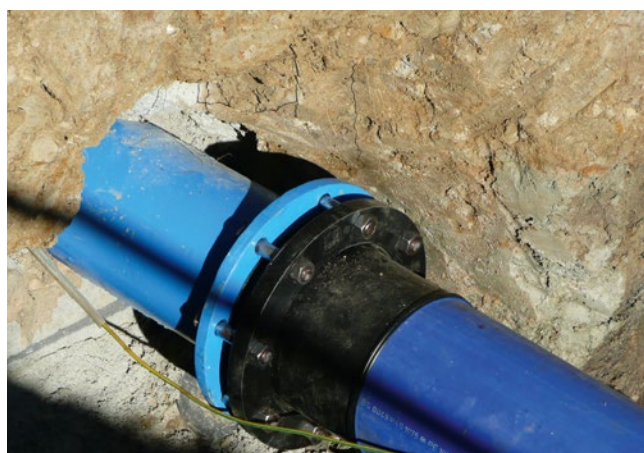
Spoj na tupo a přírubový spoj d280 mm ze stavby ve Štítarech
